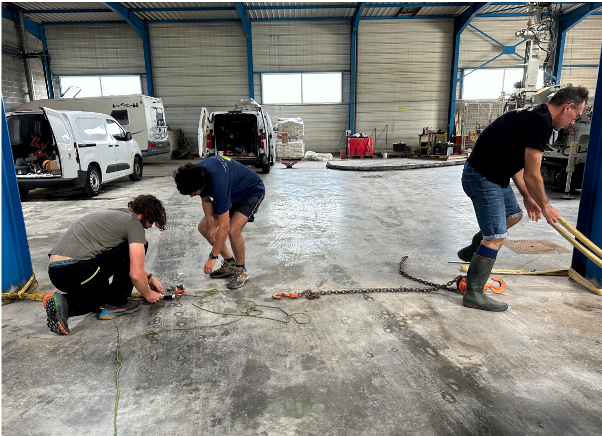
Antoine Heil, Felix Nilius et Pierre Boudinet installent l'atelier de traction lente dans l'entrepôt de Christophe Rognon.
